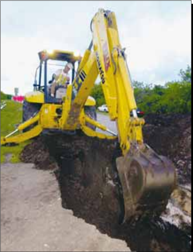
La retrocargadora Komatsu WB140-2 excava una zanja antes de tender un tubo.
