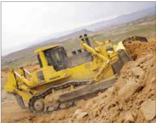
La fuerza poderosa de empuje y desgarre del D475A ha reducido en un tercio el presupuesto de voladuras de Gilbert Development Corporation.
