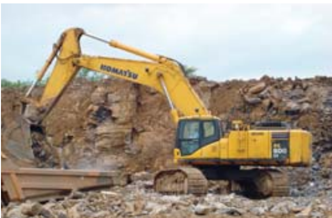
La excavadora hidráulica PC600LC descarga en un camión volquete en la mina de piedra caliza de Jaypee
