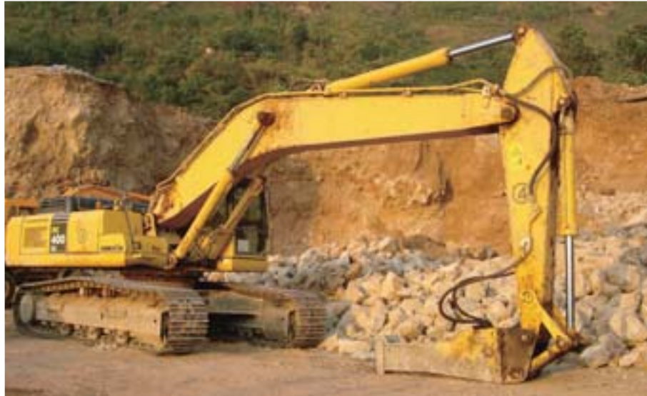
La excavadora hidráulica PC400LC con un triturador de rocas trabajando en el sitio de Karcham Wangtoo
